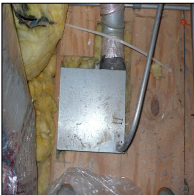
Exposed bath fan
